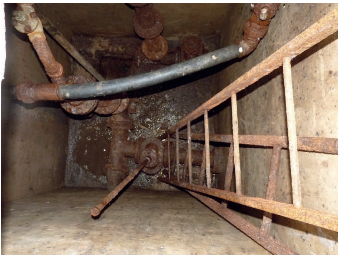
Pohled do armaturní komory
