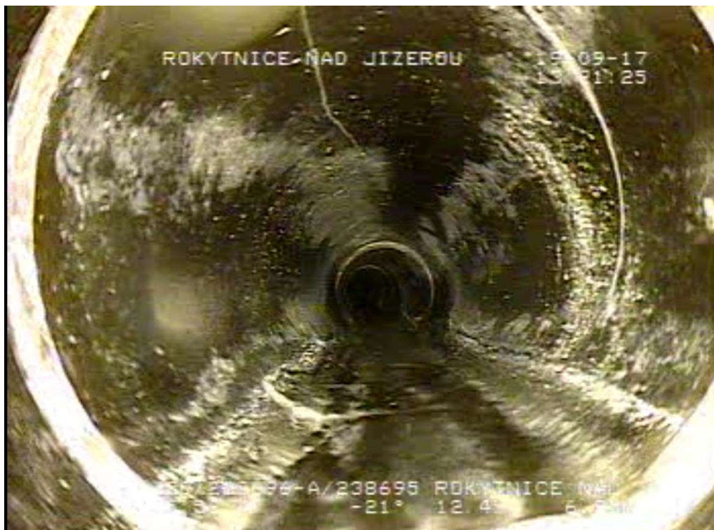
Obr. č. 19: 3 - Horní Rokytnice (1034764 - 238695) - Tvorba prasklin. - Rokytnice nad Jizerou
