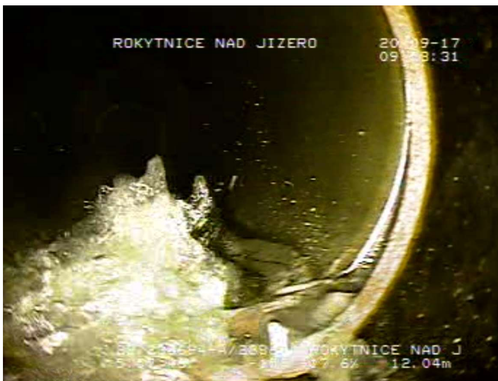
Obr. č. 22: 3 - Horní Rokytnice (238694 - 1054869) - Posunutý spoj. Možný nátok vody ve spoji? - Rokytnice nad Jizerou
