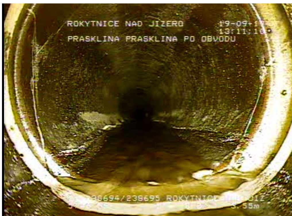
Obr. č. 20: 3 - Horní Rokytnice (238695 - 238694) - Tvorba prasklin. - Rokytnice nad Jizerou
