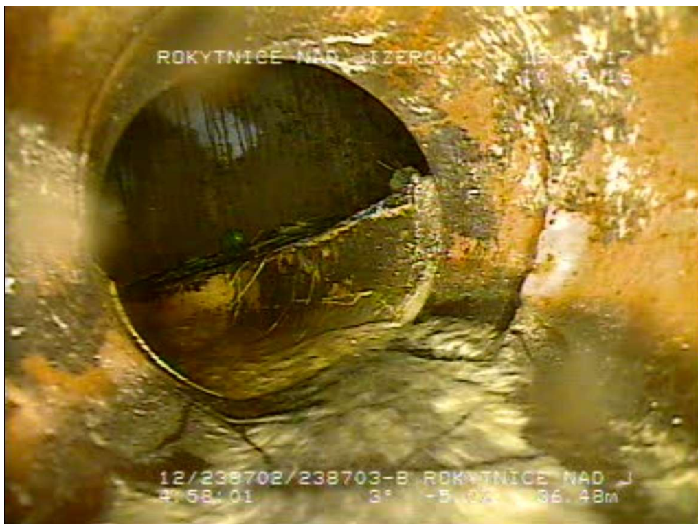
Obr. č. 3: 3 - Horní Rokytnice (1034757 - 238702) - Napojení stoky na šachtu, praskliny. - Rokytnice nad Jizerou
