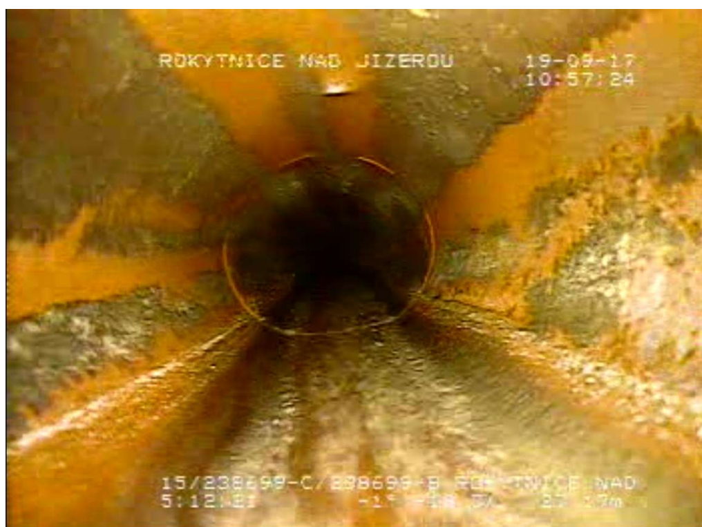
Obr. č. 12: 3 - Horní Rokytnice (1034762 - 1034763) - Deformace stoky – ovalita, nerovnost potrubí na stropě. - Rokytnice nad Jizerou
